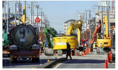
道路陥没事故の現場周辺=10日、埼玉県八潮市(共同)
